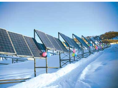
В 2014 году построили и запустили солнечную электростанцию в поселке Эльбеза
